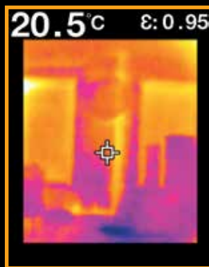
Tubazioni calde nelle pareti
